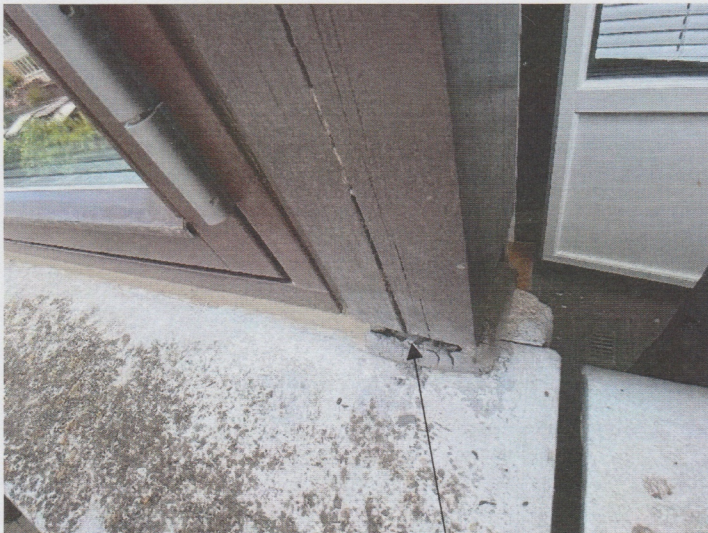
Defekt fuge og algevækst på sålbænk
