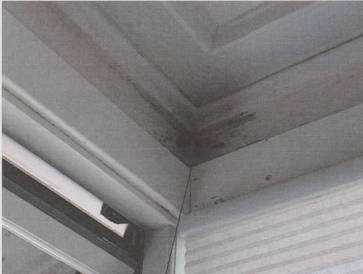
Skimmeldannelse ved loft.
