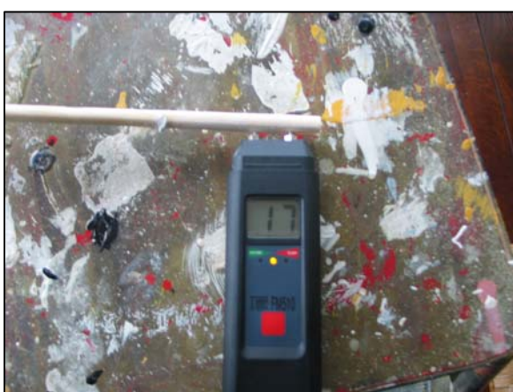
Fugt i dyvel placeret i murværk en uge efter. Fugtighed 17%
