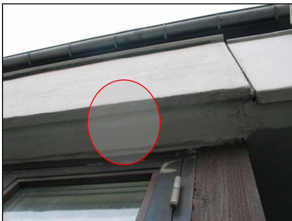
Karnap udvendigt, det skraverede område indikere kuldebro samt skimmel på indvendig side.
