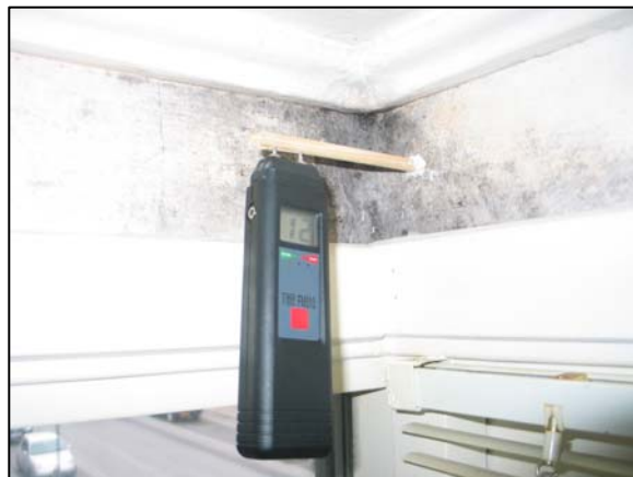
Fugt i dyvel placeret i lejlighed en uge efter. Fugtighed 12%
